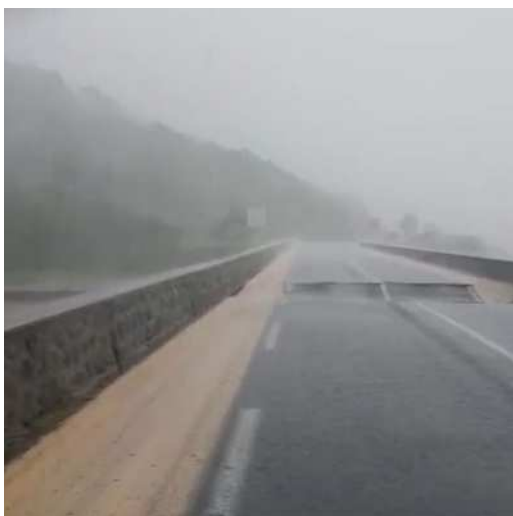
Photographie : Chaussée dégradée suite au passage du cyclone Garance en Février 2025, Photographie d'Outre-Mer la 1ère.
