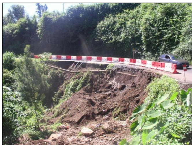
Figure 15 : Glissement de terrain à Saint-Leu sur la RD3 en mars 2005 (©BRGM)
