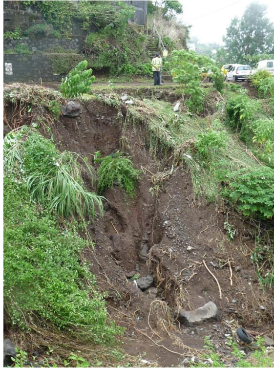
Figure 16 : Glissement superficiel impactant le talus sous la RD3 au PR131, à Saint Leu suite aux fortes pluies du 5 février 2012 (rapport BRGM/RP-60841-FR)
